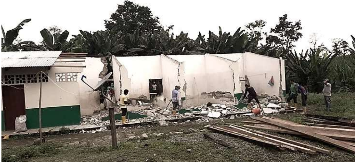
Campamento de Furukawa con los colores de la empresa, donde vivían las familias, demolido
